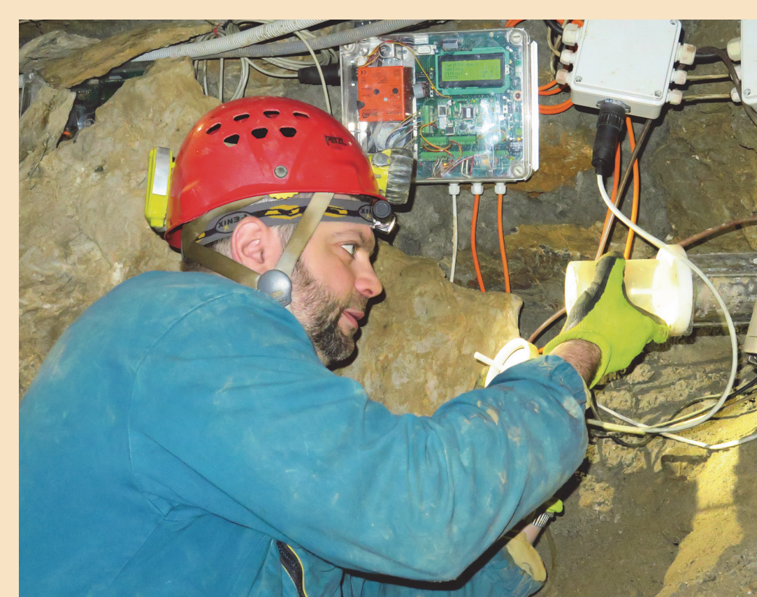
Údržba kontinuálního monitoringu CO 2 zajišťujícího bezpečnost návštěvní trasy, 2019
