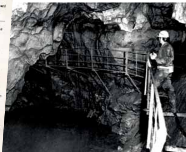
Stav ocelové lávky nad Hlubokým jezerem v roce 1994 při provádění projekčních prací na zpřístupnění Císařské jeskyně.
