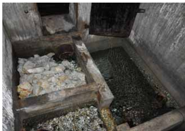
Podzemní část jímacího objektu Rutické vyvěračky. Vnitřní uspořádání se prakticky nezměnilo od rekonstrukce v roce 1928. (Foto: František Krejča, rok 2013)
