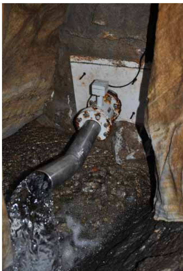
Měření průtoku podzemního toku Chýnovské jeskyně. V současné době používaný průtokový měřič byl instalován v roce 2006 a nahradil dříve používaný systém měrného přelivu s plovákem pro měření výšky hladiny. (Foto: František Krejča, rok 2013)
