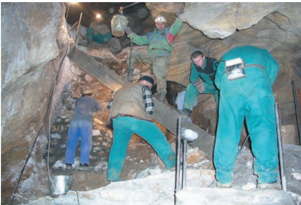
Chýnovská jeskyně, rekonstrukce návštěvní trasy. Budování mimoúrovňového křížení lávek ve Schwarzenberské chodbě. Foto: Archiv SCHJ
